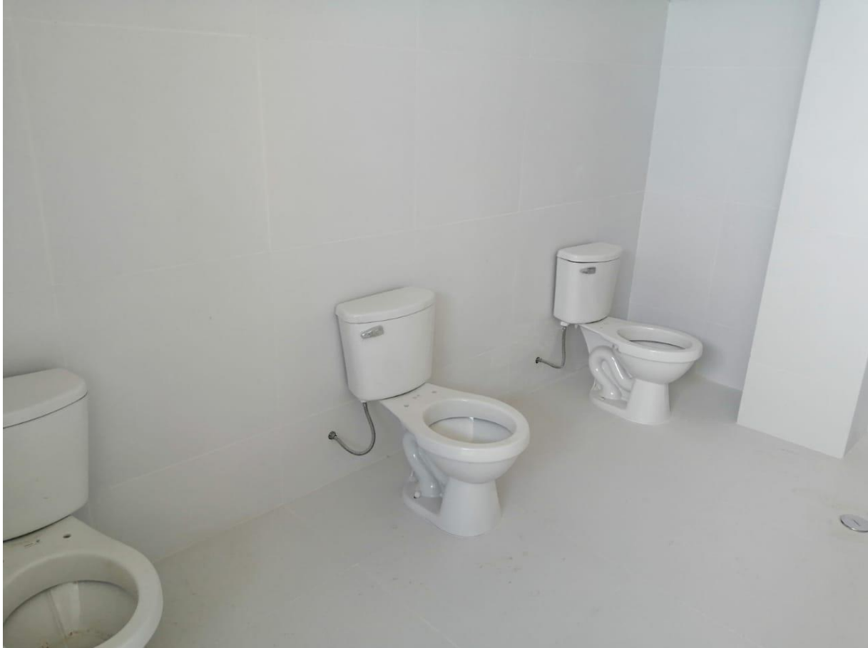
PISO Y CONTRAZOCALOS DE PORCELANATOS EN BAÑO, COLOCACION DE INODOROS Y REGISTROS
